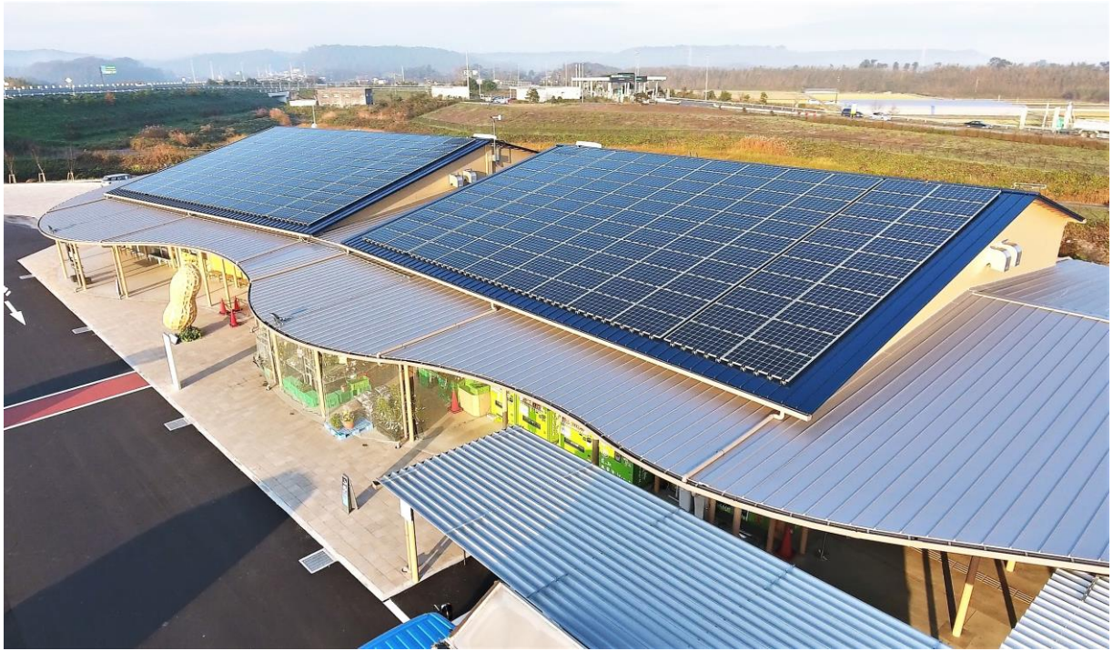
<写真上 屋根置型太陽電池モジュール>
